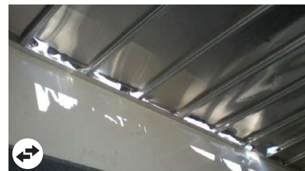
Padiglione: Telaio danneggiato, dalla riparazione antieconomica
