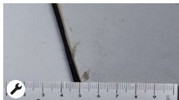
Differenza di sfumatura in seguito a riparazione
