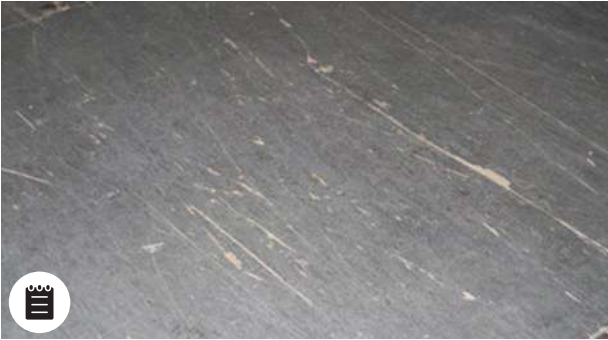
Pavimentazione: leggera deformazione, usura superficiale
