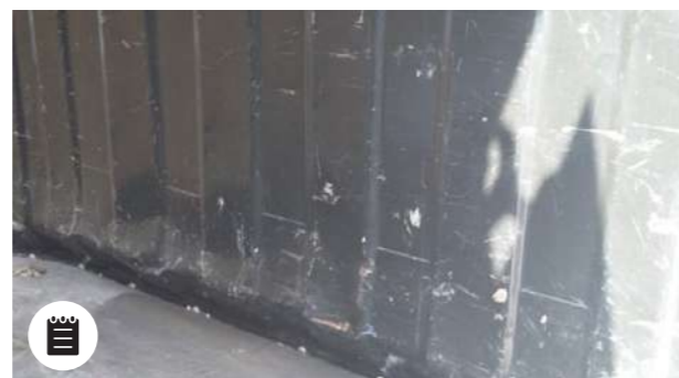
Deformazioni interne: Leggera deformazione senza perforazioni o tagli, tempo di riparazione \leq 3 h
