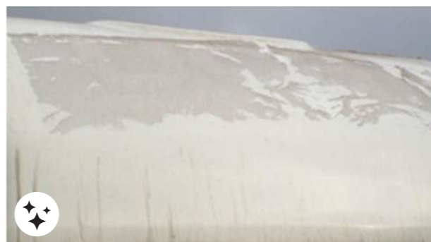
Tracce di colla. Nota: Presenza di tag o graffi, valutazione in tempo reale durante l'intervento di pulizia e/o lucidatura
