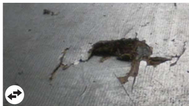
Pavimentazione: Deformazioni o perforazioni dalla riparazione antieconomica. Possibilità di sostituire la pavimentazione per sezioni.
