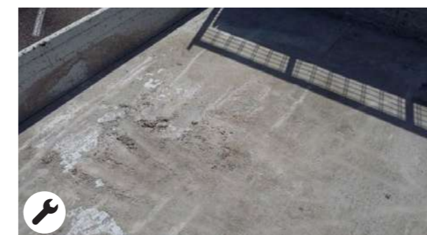
Tracce di cemento o prodotti chimici su superfici \geq ¼ del cassone
