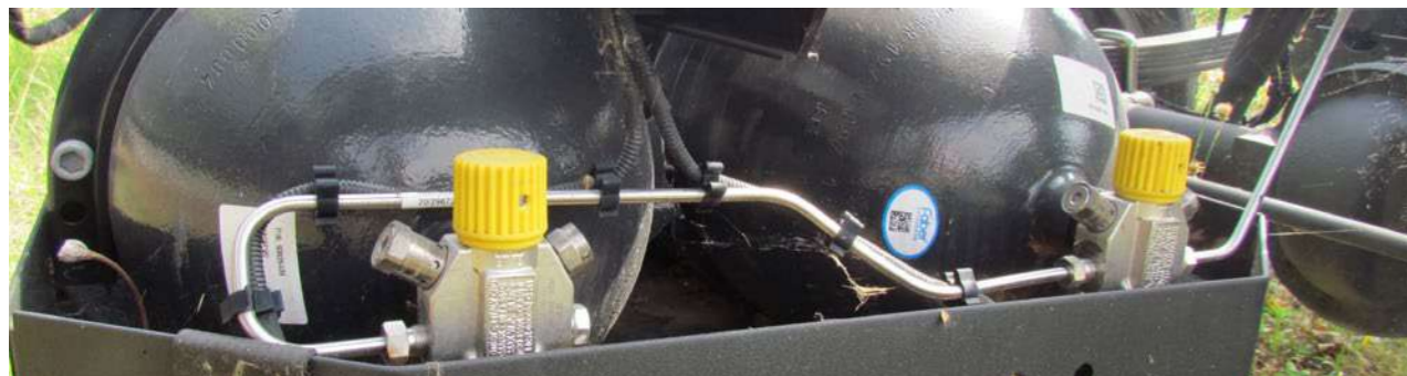
Le tubature devono essere restituite in buone condizioni come illustrato in foto.
