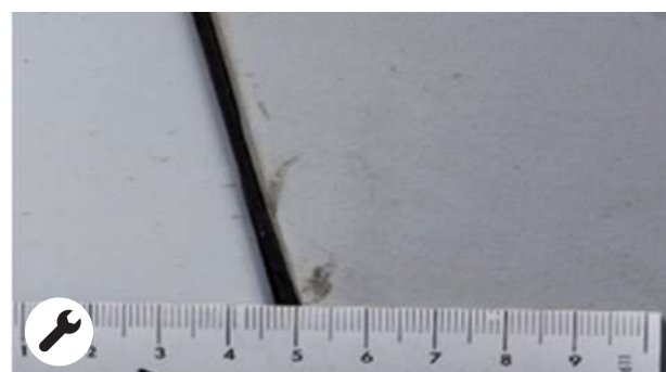
Differenza di sfumatura in seguito a riparazione
