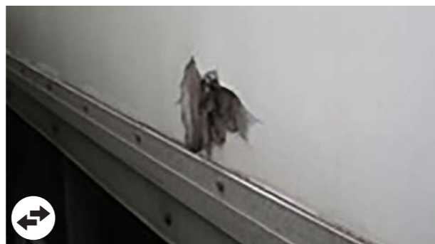
Fiancate in legno: Supporti in legno danneggiati \geq 20 cm
