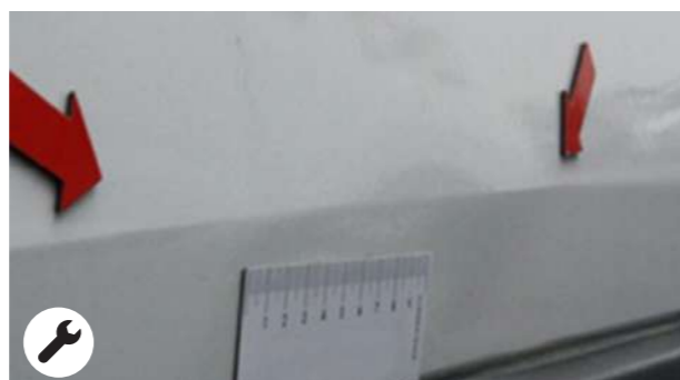
Difetto: pannello deformato in seguito a riparazione
