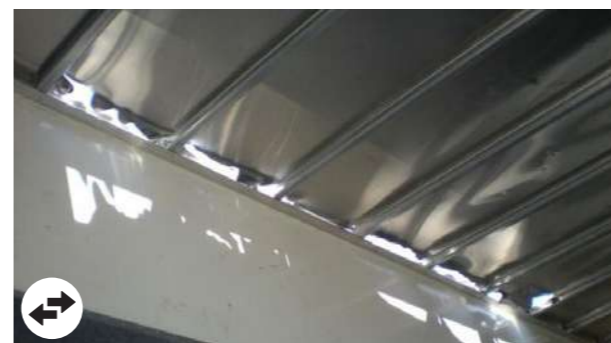
Padiglione: Telaio danneggiato, dalla riparazione antieconomica
